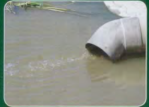
Salida agua depurada
