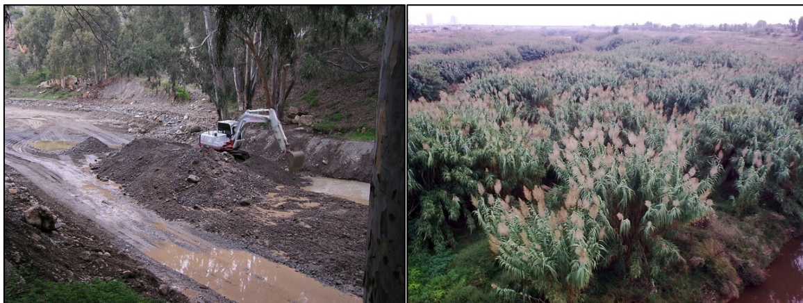
Fotos 1 y 2. Habituales trabajos de limpieza de un cauce con maquinaria pesada (izquierda). (c) Óscar Gavira). Masas de caña invasora ( Arundo donax ), especie que prolifera sobre todo en tramos de ríos regulados o con aguas contaminadas por nutrientes procedentes de vertidos de aguas residuales o de la agricultura (derecha). (c) Evelyn García).
